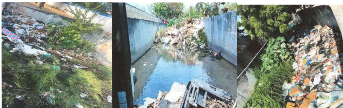
Ilustración 2 Estado inicial del Tramo del arroyo el Salao Barrio Salamanca.
