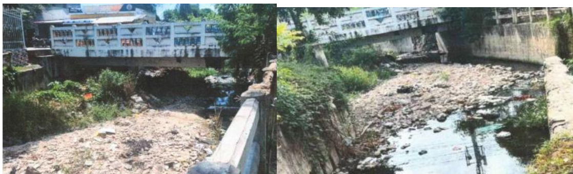
Ilustración 5 Estado inicial del Tramo del arroyo Paso el Libertador.
