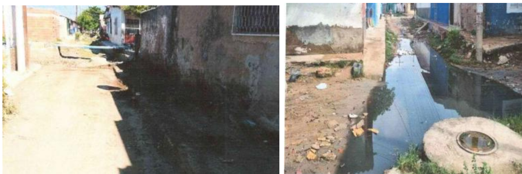
Ilustración 9 Resultado del Tramo del arroyo Cachimbero Barrio 12 de octubre.
